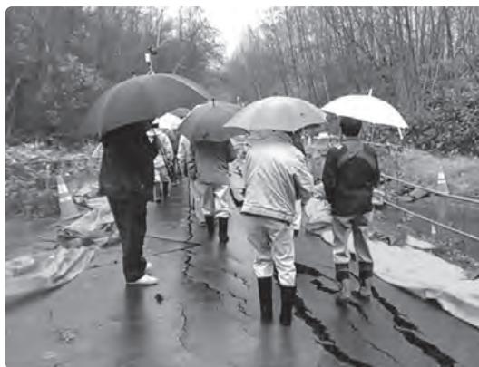
幸内地区 地すべり箇所の状況
