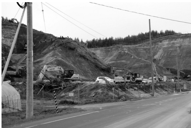
胆振東部地震被災状況(東和地区)視察
